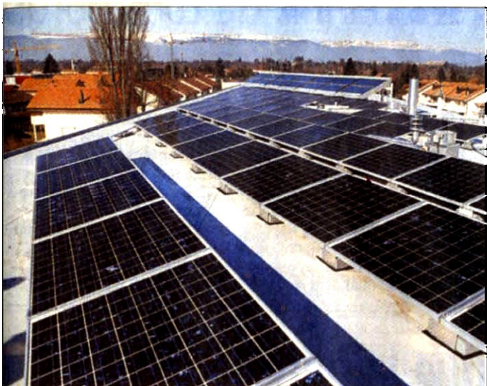
Sur les toits. Les panneaux photovoltaïques et thermiques tournent à plein régime.
