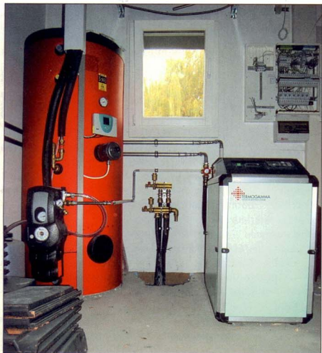
Le local technique, avec le boiler SolKit de 400 litres relié aux capteurs solaires et la pompe à chaleur d'une puissance de 8.2 kW.
