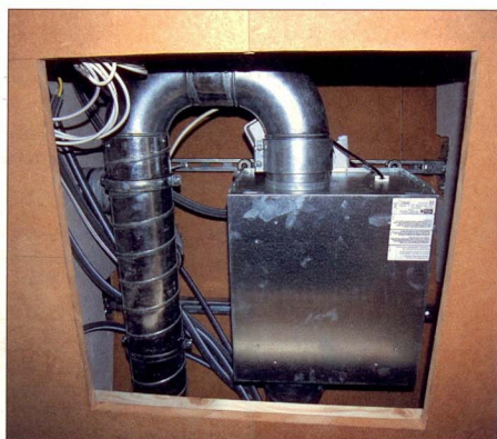
Un monobloc – intégré dans le faux-plafond d'un WC – fonctionne 24 heures sur 24 sur la base de 60 m 3 /h pour procurer un minimum de mètres cubes de ventilation dans les chambres et le séjour, où des entrées d'air spécifiques ont été ménagées dans le plafond.
