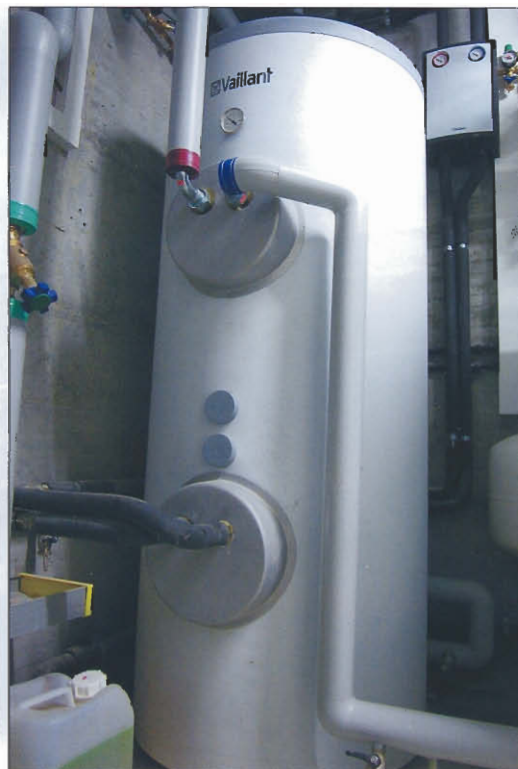
Une pompe à chaleur de 8 kW de puissance assure le chauffage et la production d'eau chaude sanitaire.
