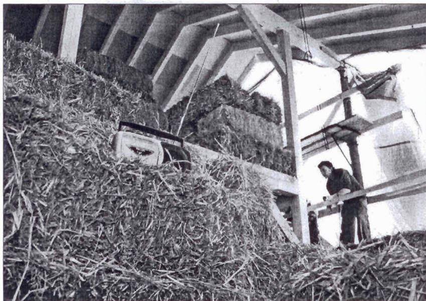
BOTTES Les «briques» de paille qui constituent le matériau pour les murs sont entreposées sous le toit, abritées de la pluie par des bâches. MORRENS, LE 7 JUILLET 2009
